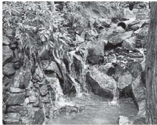
石垣が崩壊し土砂が流出する松浜川
